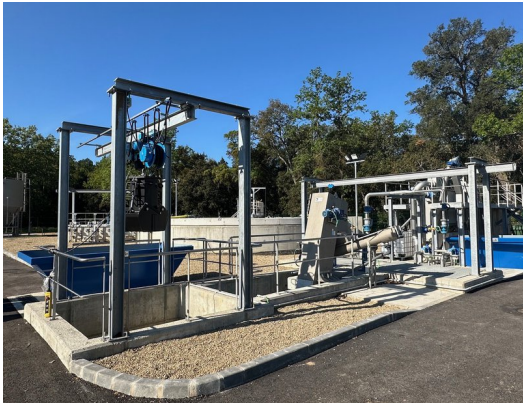
La nova depuradora de Caldes de Malavella PREMSA GENCAT.
