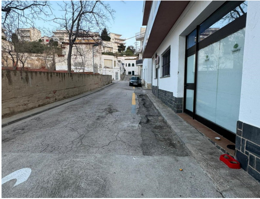
L'estat d'un dels carrers de Llançà J.T.
