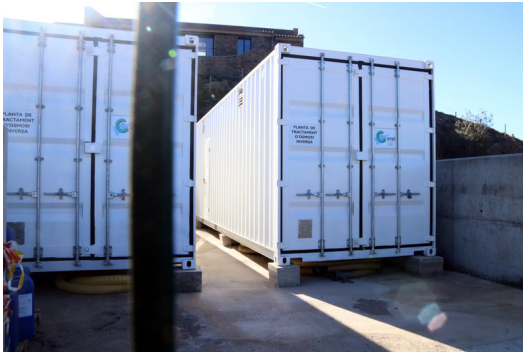
Planta dessalinitzadora dels dipòsit de Port de la Selva. G. TUBERT (ACN).
