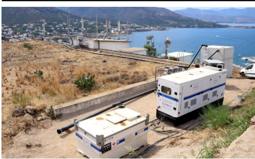
Pla general del dipòsit municipal d'aigua del Port de la Selva amb part dels aparells que complementen la dessalinitzadora ACN.
