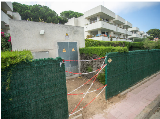
El centre transformador que la companyia admet que està afectat QUIM PUIG.
