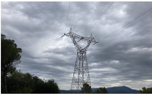
Imatge d'una torre d'alta tensió MAR FERRANDO.
