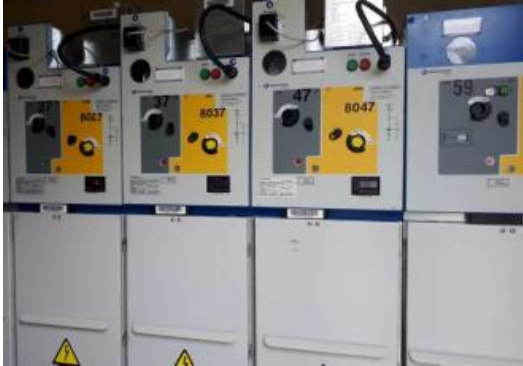
Aparells de telecomandament.
