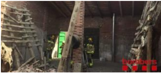
Arbúcies Cau el sostre d'una casa deshabitada
