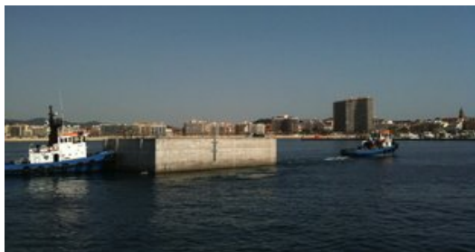
El primer calaix per construir el nou dic de Llançà va ser traslladat de Tarragona a Palamós el cap de setmana. Foto: EL PUNT.
