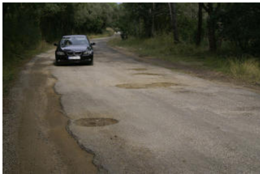
Estat actual de la carretera-camí de Romanyà al Mas Nou. <br/>
